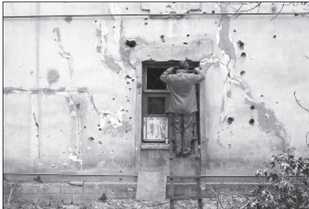
Здание в Дебальцево (Донецкая область), поврежденное в ходе обстрела, 22 сентября 2014 года
